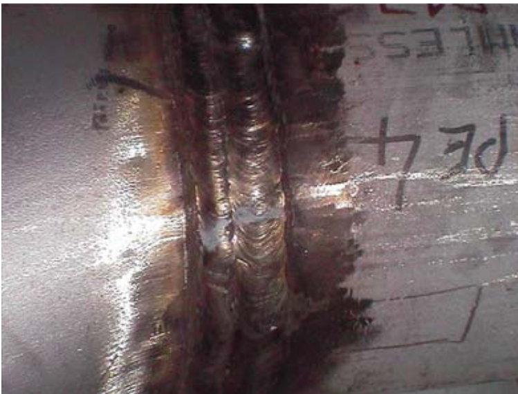
Unbehandelte Schweißverbindung: Die Zunderschicht kann Ausgangspunkt von Korrosion werden, wenn sie nicht sachgemäß entfernt wird.
